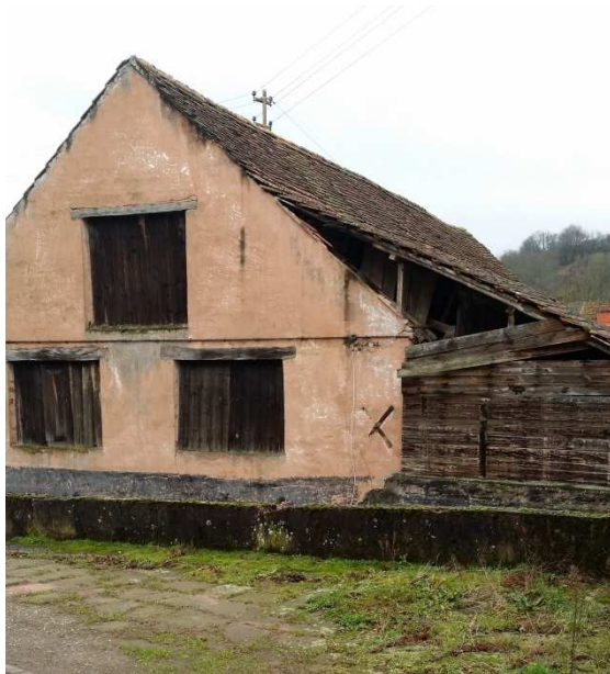
Abb. 48: Gebäude in schlechtem Zustand
