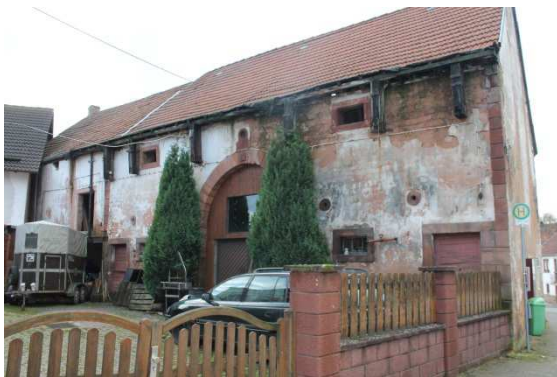
Abb. 35: Gebäude im schlechten Zustand
