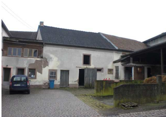
Abb. 15: Haus-Hof-Bebauung im schlechten Zustand
