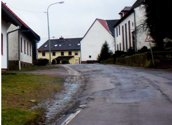
Abb. 18: Adam-Müller-Straße am nördlichen Ortseingang im schlechten Zustand
