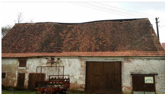
Abb. 49: Landwirtschaftliches Gebäude in schlechtem Zustand
