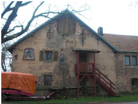
Abb. 16: Wohngebäude im schlechten Zustand
